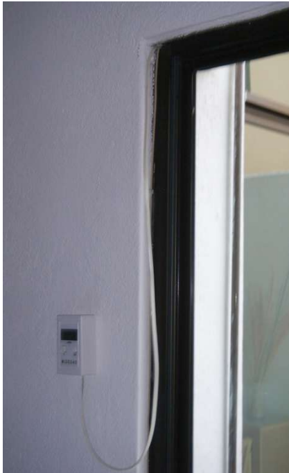
Medidor fijado en una cocina y el cable extensión pasado a través del marco de una ventana
