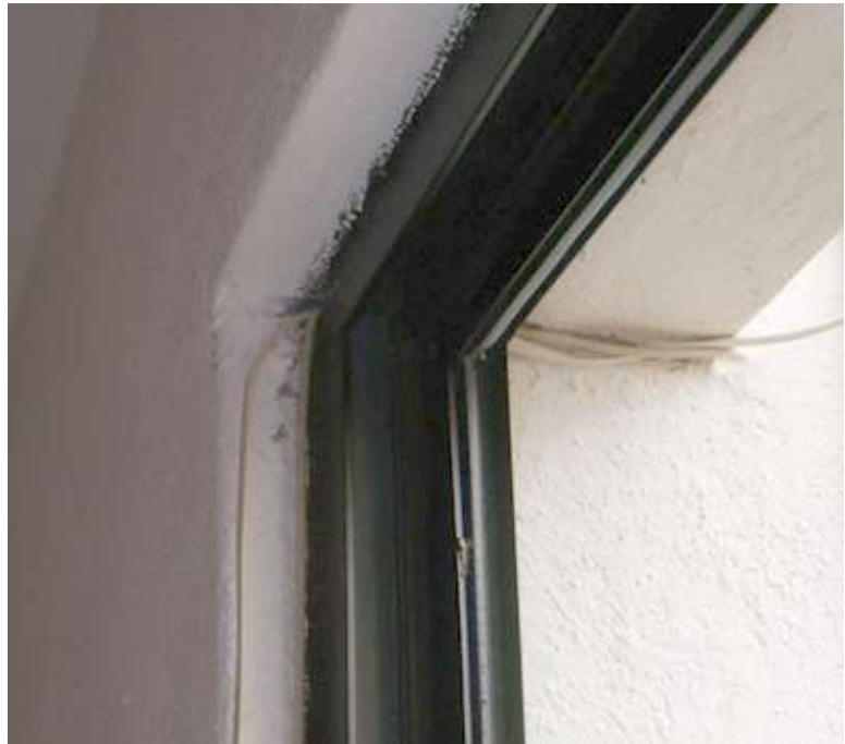
Detalle que muestra el cable extensión y el cable del teléfono pasado a través de una perforación hecha en el marco de una ventana.
